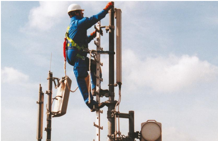
Antennenträger (Dachstandort) mit Sektor- und Richtfunkantennen
