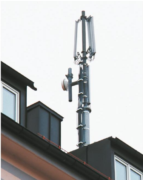
Basisstation auf Wohnhaus
